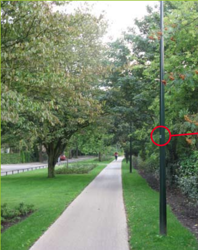
LED-lichtmasten langs een fietspad.
